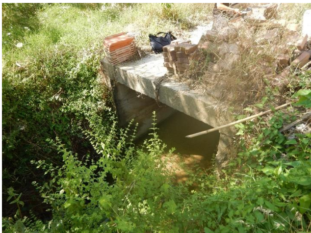
Figura 9: Sblocco del tratto tombato su via Spano – Inizio del tratto di intervento
