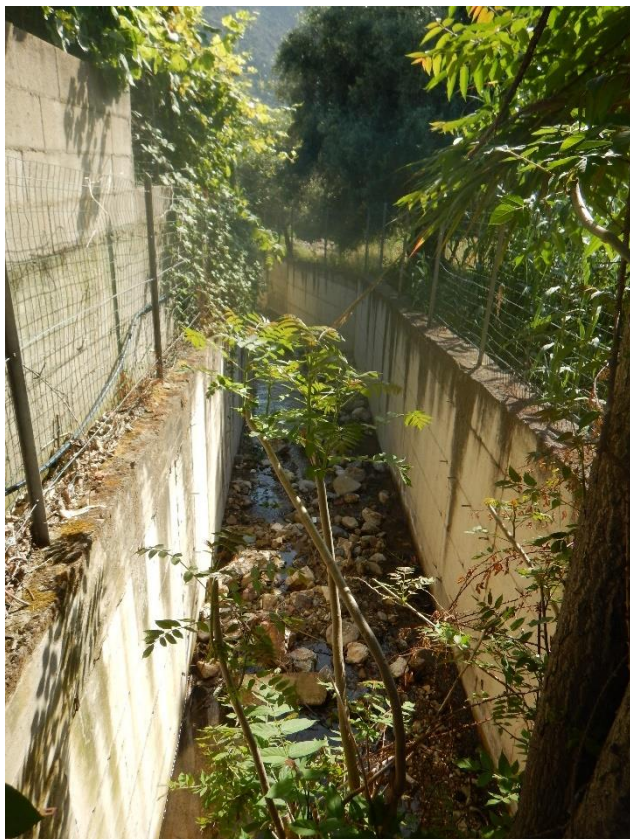
Figura 5: Canale in calcestruzzo - tratto subito a valle dello sbocco del tratto tombato di monte - vista da Via Pietro Nenni.
